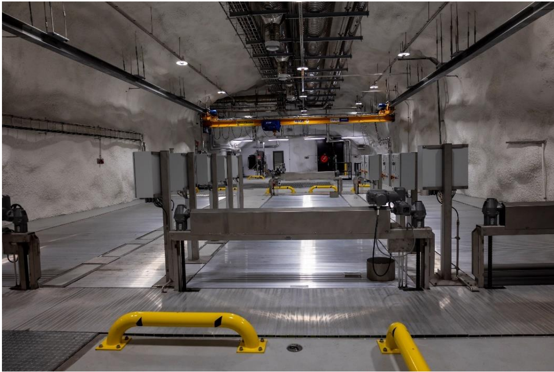
Turun Seudun Puhdistamon uusi UV-laitos. Kuva: Tero Säteri
